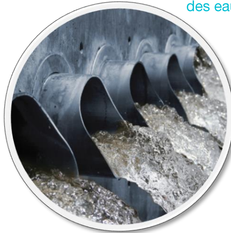
Une station d'épuration des eaux usées
